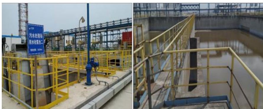
炼油改扩建区雨水监控池（ 6300m^3 ）
